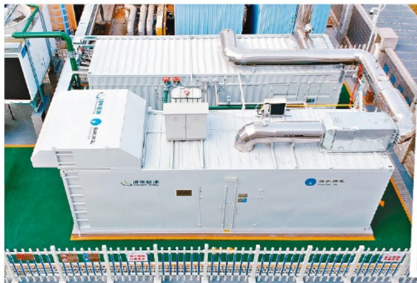
煤氣公司一直致力推動能源技術創新。深燃大廈綜合能源項目是集團屬下港華能源第一個以燃氣分布式能源為主，綜合光伏及儲能，提供多能源穩定安全供應的「源網荷儲」一體化能源互聯網示範項目。
